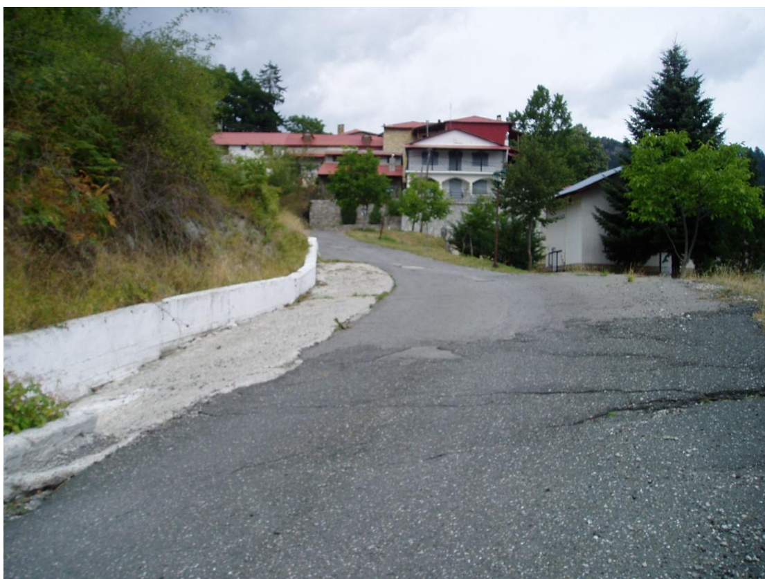
Φωτογραφία 6: Θα κατασκευαστεί τάφρος τριγωνικής διατομής μήκους 60,00μ. και θα ανακατασκευαστεί όλη η οδός για μήκος 110,00μ.
